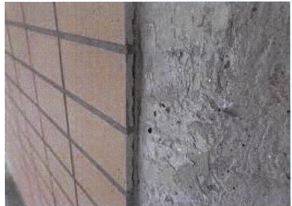
タイルの一部が剥落した状態
