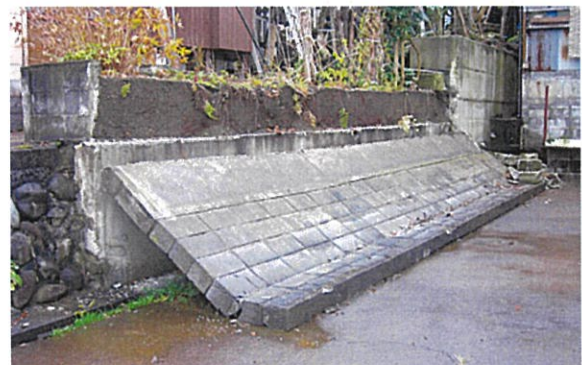
倒壊したブロック塀
