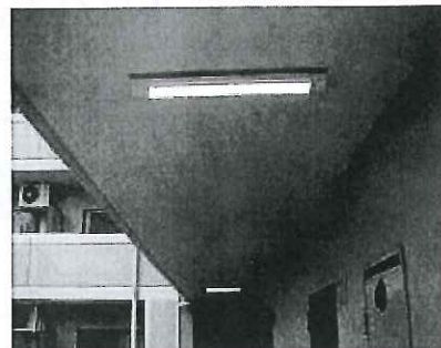
(開放廊下、LED直管) ↑
